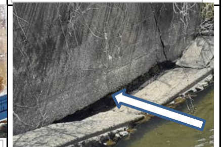
3月21日(土)小田厚道下流 洗堀
