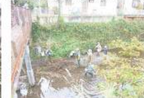
11月3日鍛冶屋橋橋桁に溜まった樹木の引き上げ
