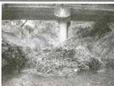
橋下に流木が貯まる
